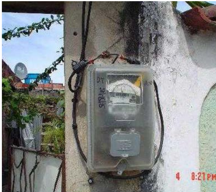
FURTO NA ENTRADA DO MEDIDOR
