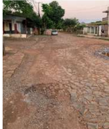
Figura 1. Área de bajos recursos con problemas de pavimentación, Jardim Ipê II.
