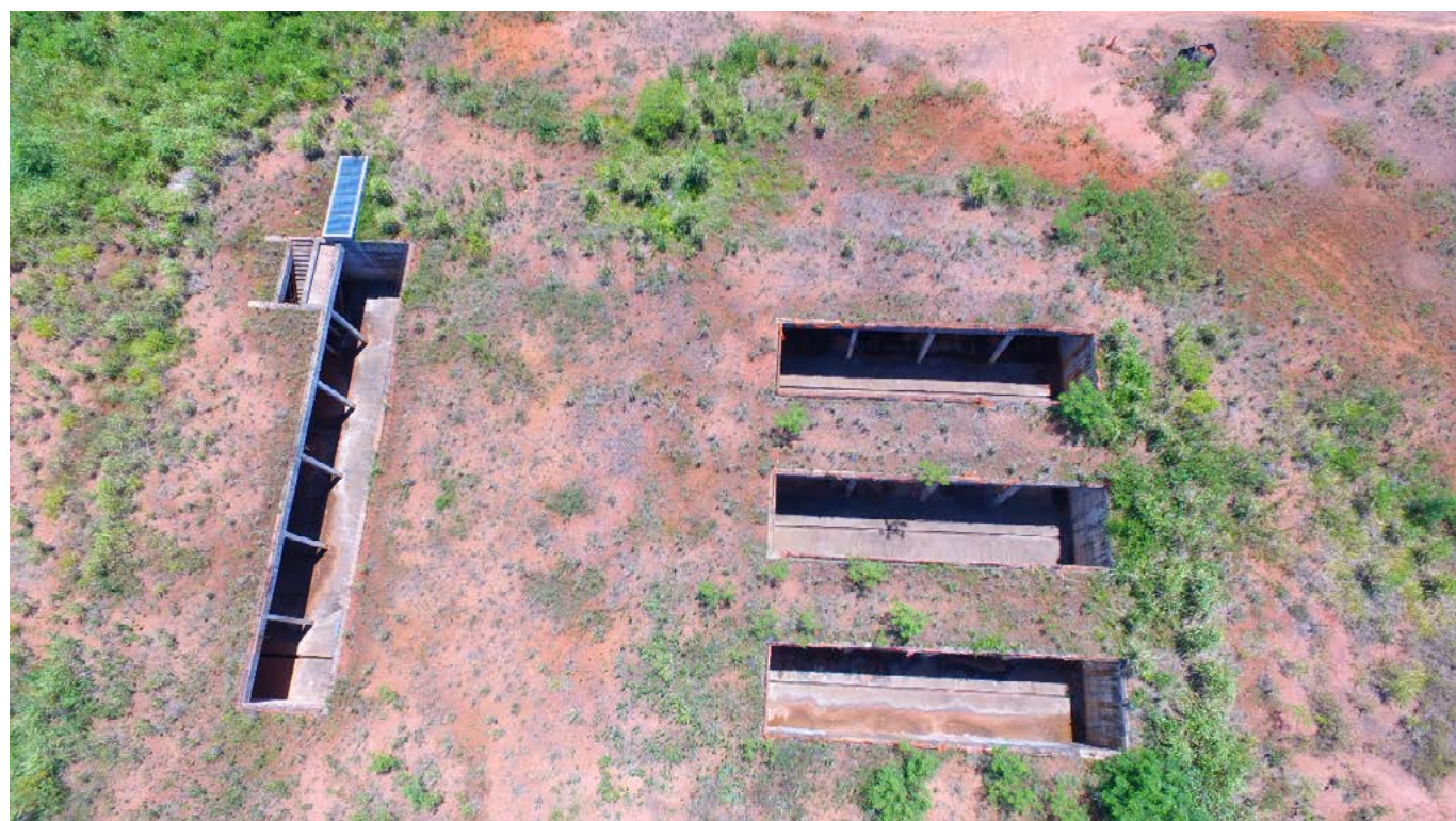
FIGURA 14: IMAGEM AÉREA DA GALERIA DE UTILIDADES (ENTRADA DA GALERIA SUBTERRÂNEA DO CAMPUS)
